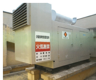
非常用自家発電設備本体
