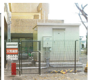
非常用自家発電機用 燃料タンク
