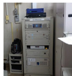
衛星通信装置(白石市庁舎)
