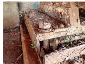
支承の腐食、アンカーボルトの欠損
