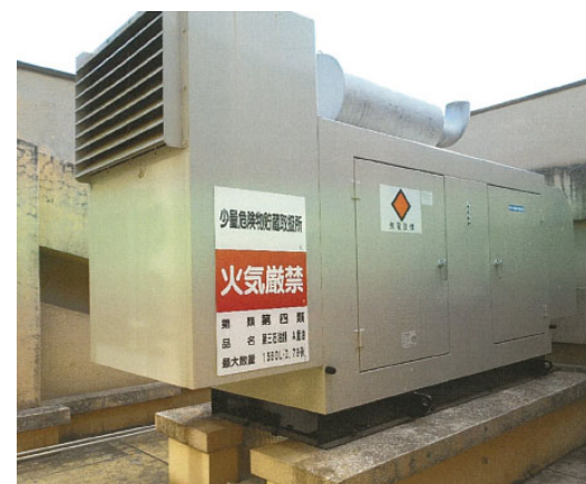
非常用自家発電設備本体
