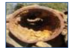
管路の老朽化が進行
