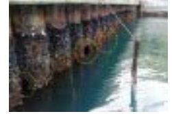
防波堤の老朽化
