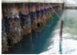
防波堤の老朽化
