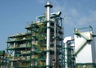
木質バイオマス発電所
