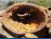
管路の老朽化が進行
