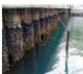
防波堤の老朽化
