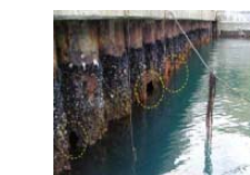
防波堤の老朽化
