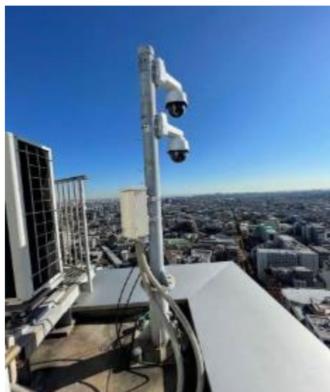
◀ 「タワーホール船堀（船堀4）」展望塔に設置した高所カメラ
