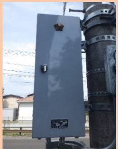
信号機電源付加装置
