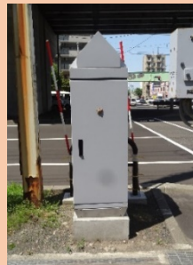
信号機電源付加装置
