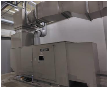
自家発電設備の更新
