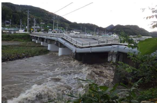
令和元年東日本台風による被害（国道20号）
