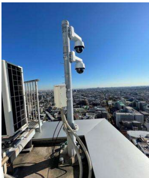
◀「タワーホール船堀（船堀4）」展望塔に設置した高所カメラ
