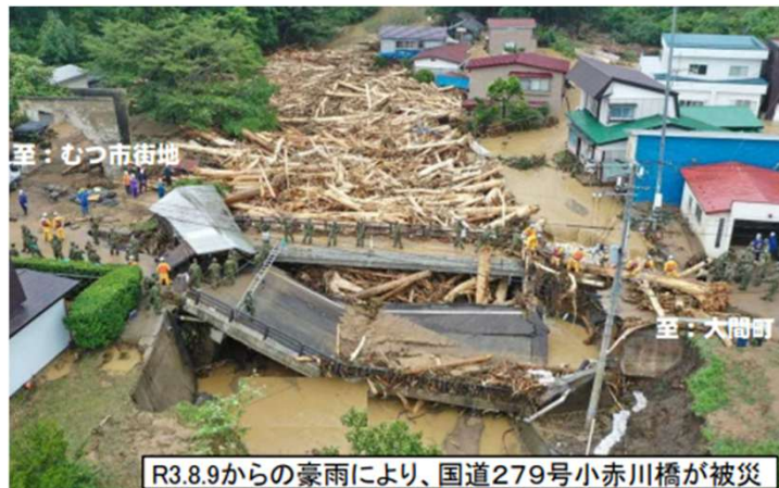
小赤川橋の崩落
