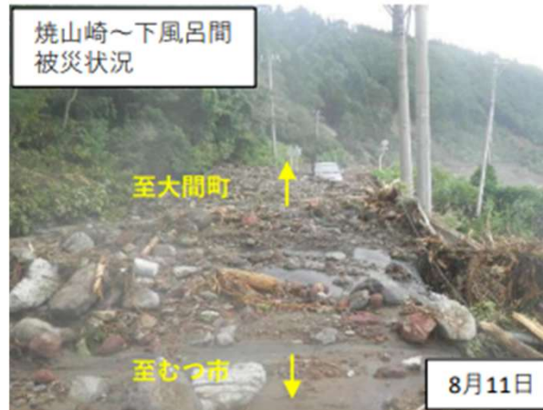
国道279号の斜面崩落
