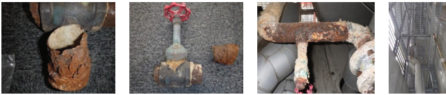
部材によって異なる腐食発生の様子、外見上腐食が進んでも使用に耐えるものは延命処置
