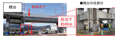
大規模地震による高架橋の被災状況
