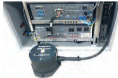
新型強震観測装置 (上: AD・電源装置、下: 換振器)
