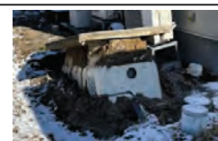
地震により浮き上がった浄化槽(画像は七尾市内の例)
