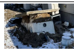
地震により浮き上がった浄化槽(画像は七尾市内の例)
