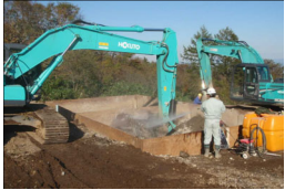
現場発生材を使用した砂防ソイルセメント工法による打設
