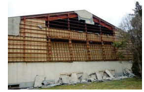
外壁の全面的な脱落
