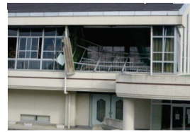
横連窓の障子ごとの脱落
