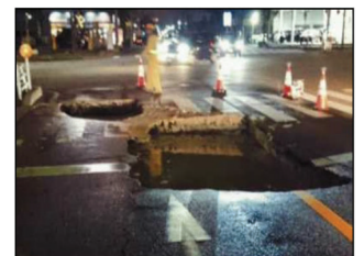
下水道に起因した道路陥没
