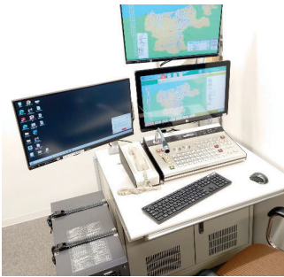
<防災行政無線 操作卓(鳥取市)>
