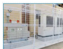
GHPと非常用発電機(日新小学校)
