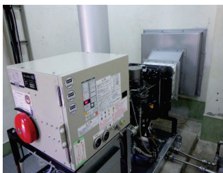
整備した非常用電源設備
