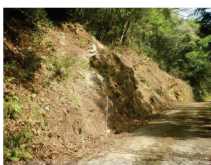
（のり面が不安定な林道）
