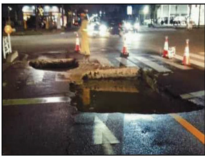
下水道に起因した道路陥没
