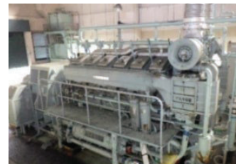
【停電対策の例：自家発電機】
