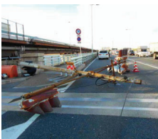
信号柱の倒壊
