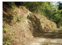
（のり面が不安定な林道）
