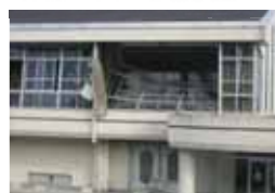
横連窓の障子ごとの脱落
