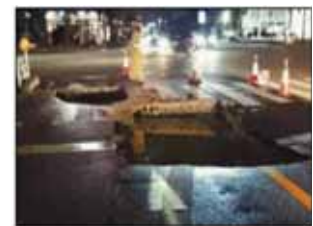
下水道に起因した道路陥没
