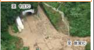
E8北陸自動車道(令和4年8月の大雨)
