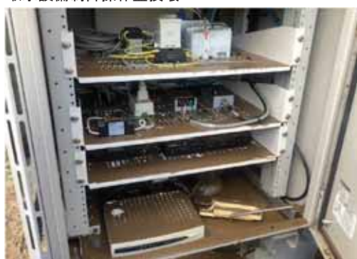
取水設備制御操作盤損壊
