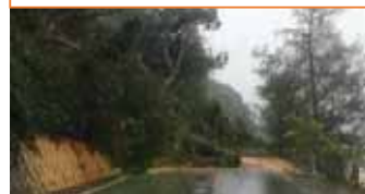
国道505号(令和5年台風6号)
