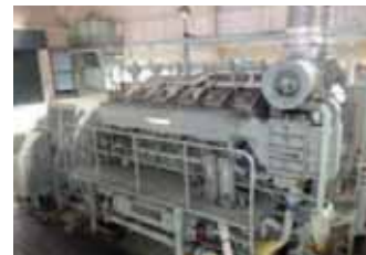
【停電対策の例：自家発電機】
