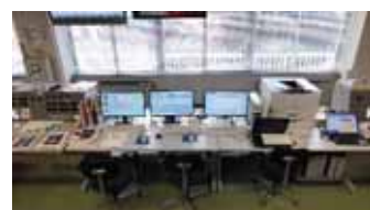
ダム管理用制御処理装置更新
