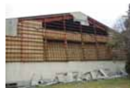
外壁の全面的な脱落
