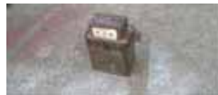
配電盤から発見されたPCB含有低圧進相コンデンサー
