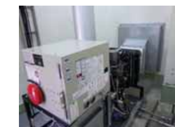
整備した非常用電源設備
