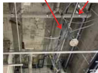
研究管理棟中央トイレの配管整備状況
