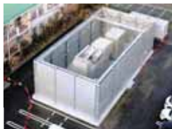
非常用自家発電設備(全景)
