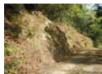
（のり面が不安定な林道）
