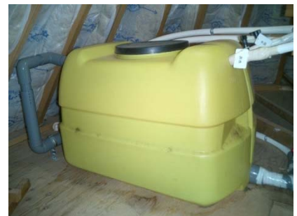
【屋根裏に作った地下水タンク】
