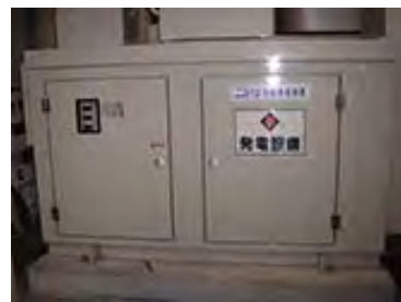
【物流施設における自家発電装置】
