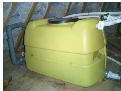
【屋根裏に作った地下水タンク】
