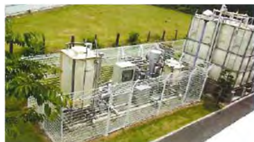
【地下水膜ろ過システム】
