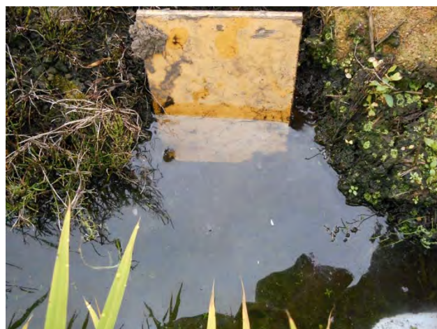
【止水板による止水状況】
