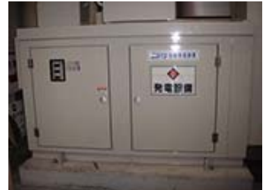
【物流施設における自家発電装置】
