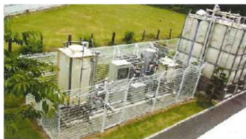
【地下水膜ろ過システム】
