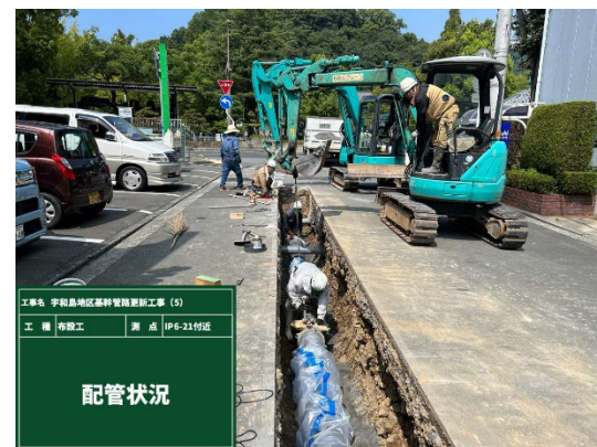
配管状況: ダクタイル鋳鉄管 (耐震継手あり、管径: 250mm)
