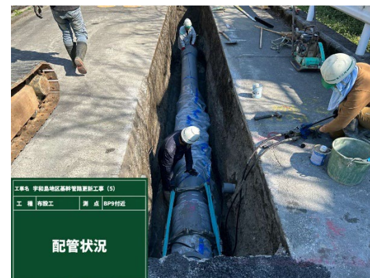
配管状況: ダクタイル鋳鉄管 (耐震継手あり、管径: 400mm)
