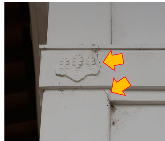
重要文化財宝蔵: 壁、床の合板補強を実施した結果、外壁漆喰のひび割れのための被害にとどまる
