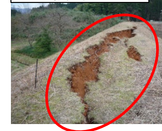
常楽池(中能登町)被災状況
