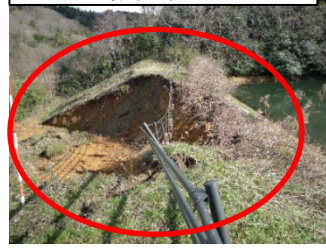
中谷内池(宝達志水町)被災状況
