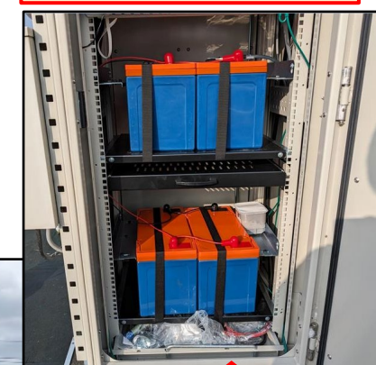
強化した非常用電源 (バッテリーの増強)
