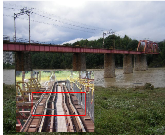
洗掘により橋脚が傾斜し、軌道狂い発生(平成23年9月)
