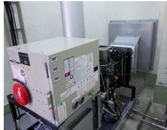
緊急対策として整備した非常用電源設備
