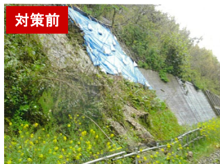
対策前 落石発生(令和2年3月)
