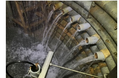
集水井の排水状況
