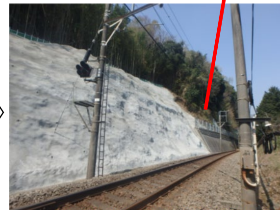
平成26年崩壊箇所
