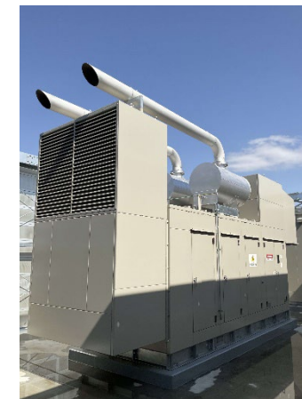
非常用自家発電設備(拡大)
