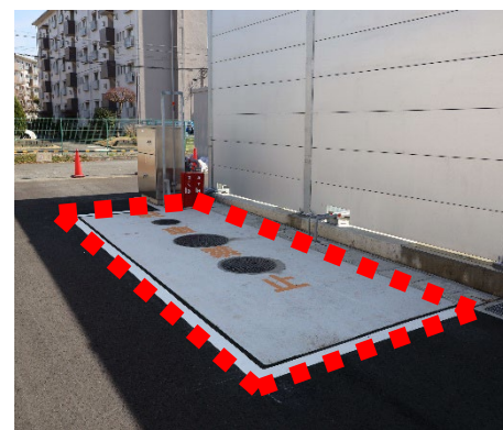
非常用自家発電設備用 埋設型燃料タンク①
