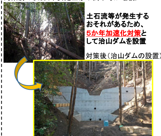
対策前の状況(不安定土砂や倒木等が堆積)
