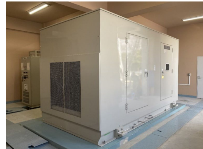
非常用自家発電設備
