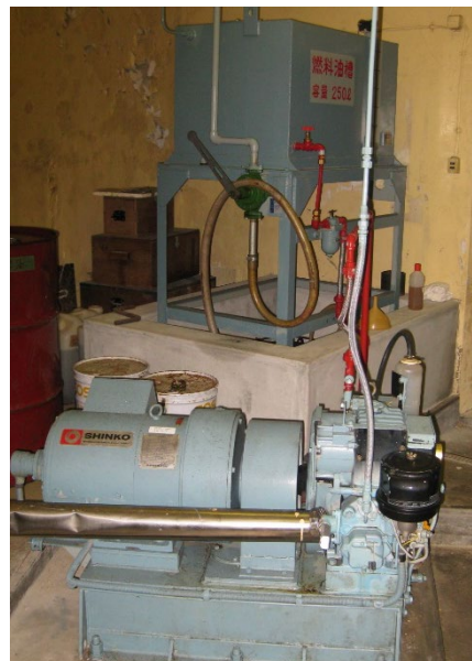
整備前 非常用発電機
