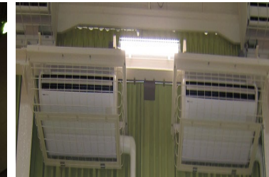
エアコン(室内機)
