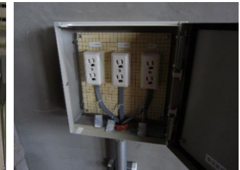
非常用コンセント
