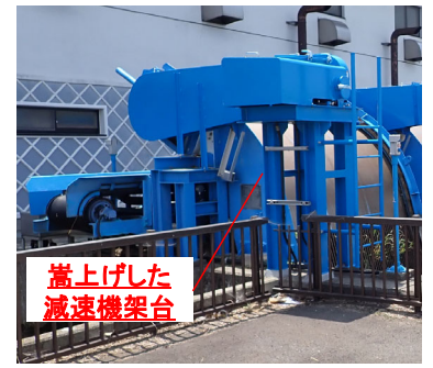
除塵設備の浸水対策
