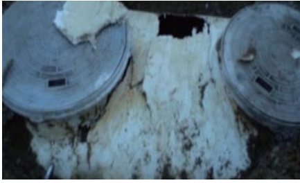
老朽化している単独処理浄化槽
