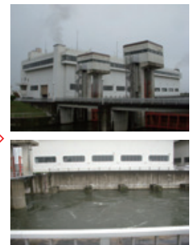
令和2年7月豪雨の際にも排水機場が稼働し湛水被害の防止に貢献しました。
