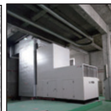
非常用発電設備
