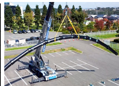
耐震型ダクタイル鉄管採用50周年セミナー (新耐震管GXφ500吊り上げ)
